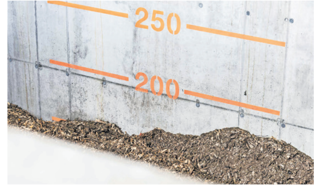
Vielfältiges Konzept: Neben der Biomasseanlage vervollständigen Wärmerückgewinnung, und Photovoltaik das energetische Konzept.
